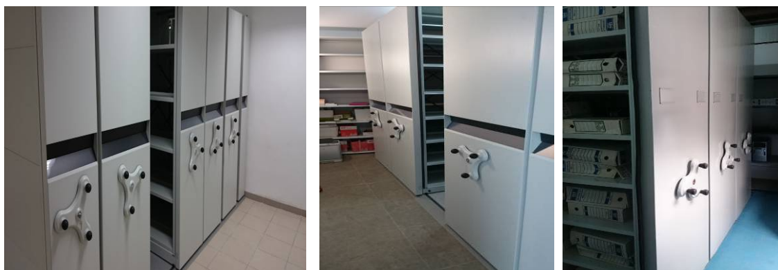
Línea de equipamiento: ejemplos de las estanterías financiadas en 2015 con las ayudas de la Comunidad de Madrid en los archivos municipales de Carabaña, Gascones y Talamanca de Jarama.
