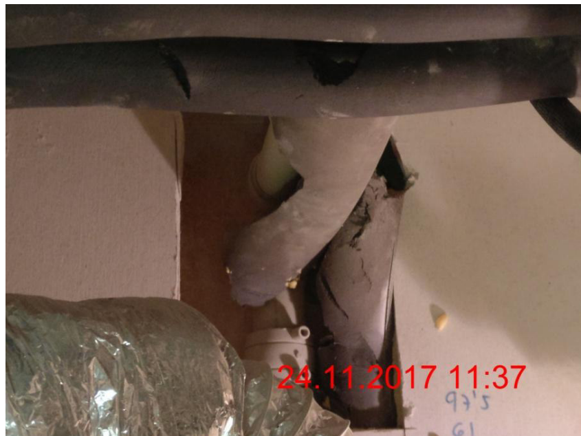
Ilustración 102: Fan-coil de Habitación 206 con aislamiento térmico dañado (foto de cerca)
