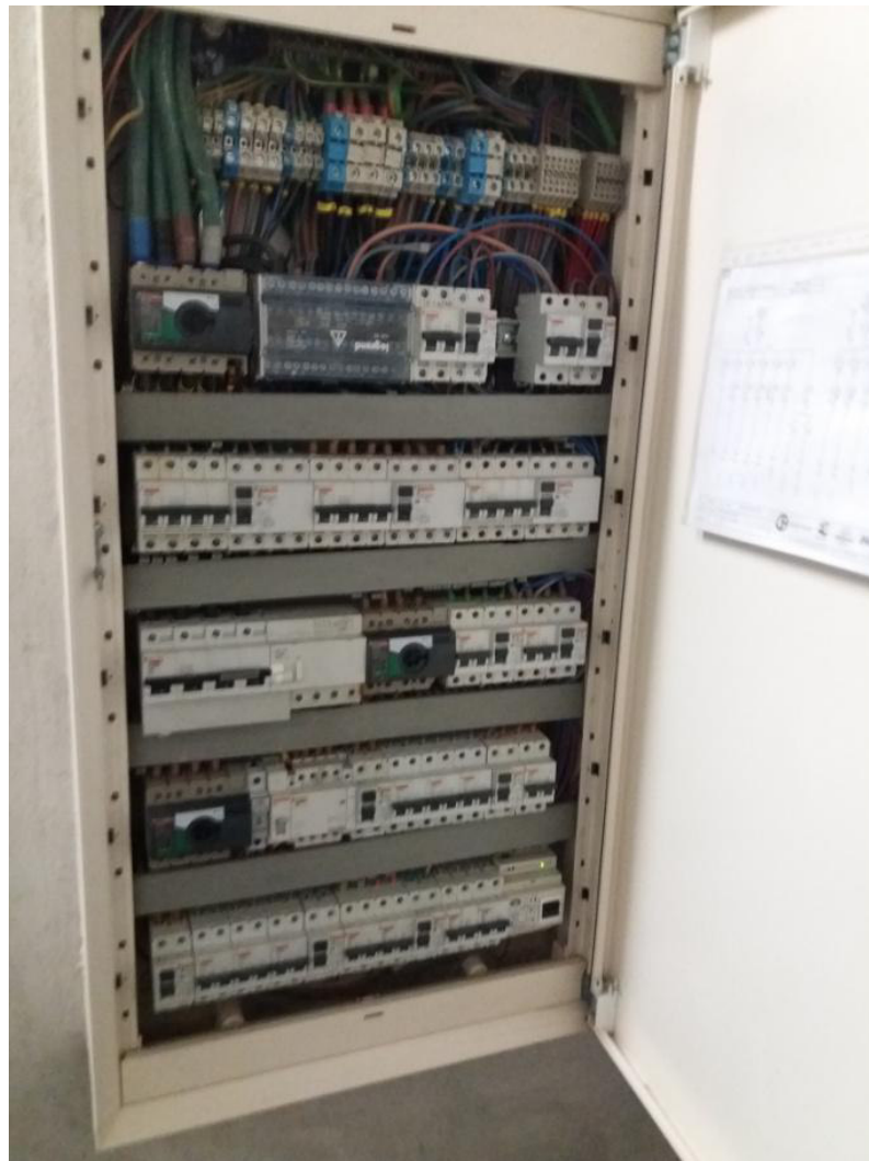
Ilustración 28: Cableado del cuadro eléctrico CD 45
