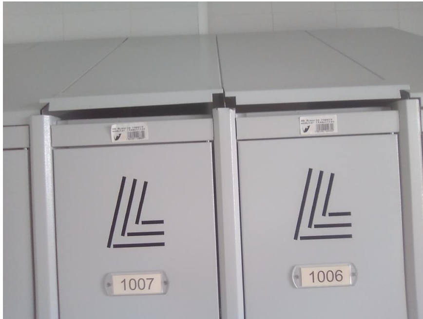
Armarios ropero modular, deteriorados, zona de vestuarios
