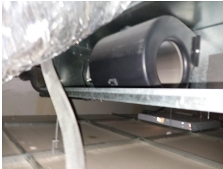
Ilustración 42: Fan-coil con acceso difícil
