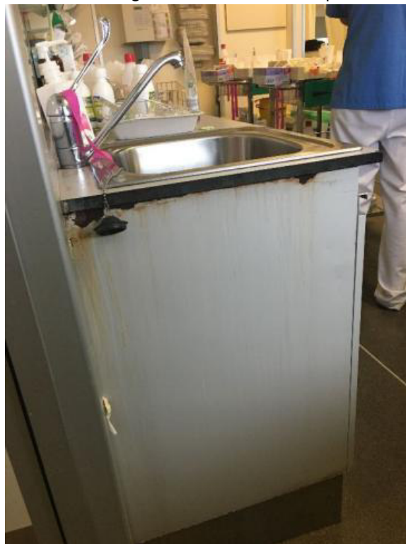
Poyata deteriorada, sin código. Ubicación: zona limpia del área de sillones
