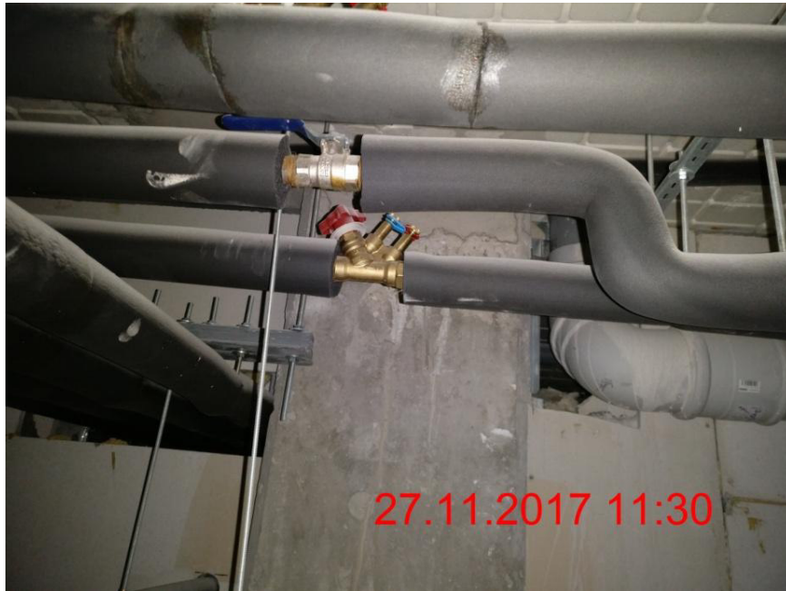
Ilustración 79: Válvula de Fan-coil de Sala de espera despacho cirugía y medicina interna sin aislante térmico
