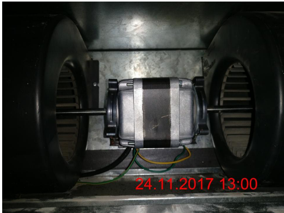
Ilustración 109: Fan-coil del Pasillo 3F con motor de ventilación roto
