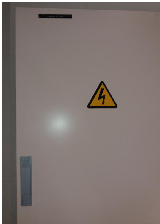
Ilustración 5: Cuadro Eléctrico 61 CAF5.
