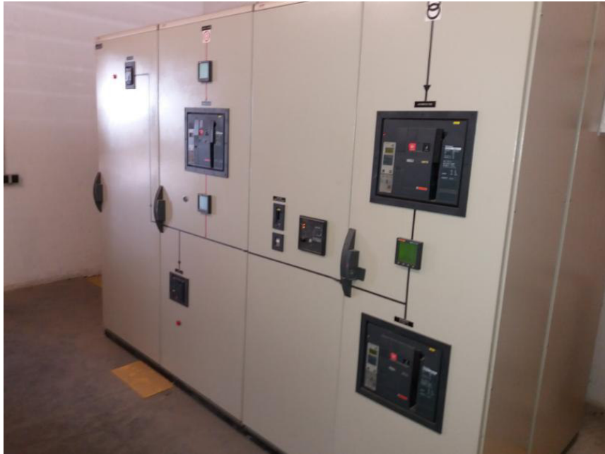
Ilustración 10: Cuadro eléctrico CGBT 2
