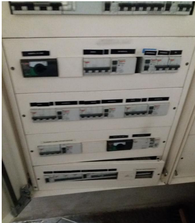
Ilustración 26: Cuadro eléctrico CD 65
