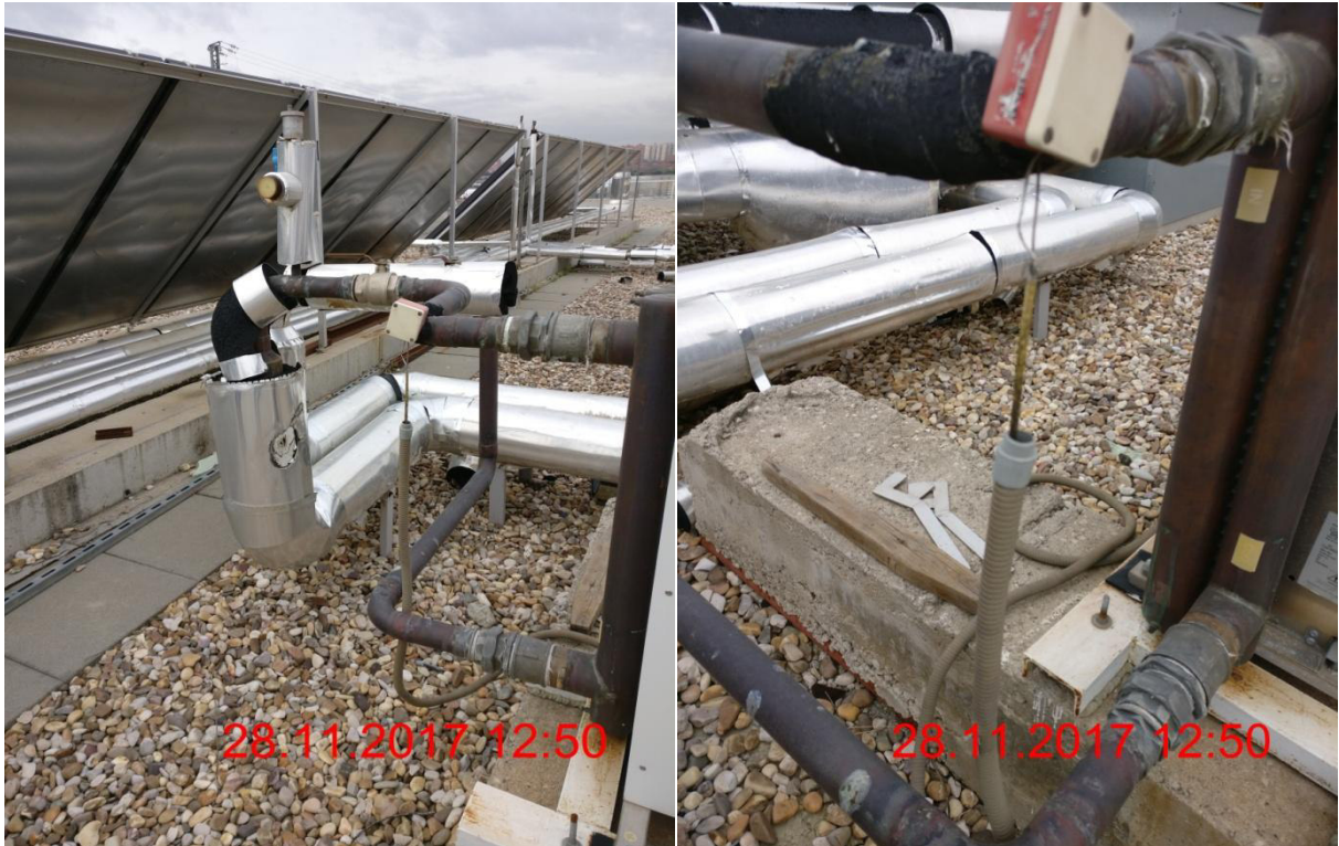
Ilustración 153: Instalación solar térmica con numerosos fallos de aislamiento
