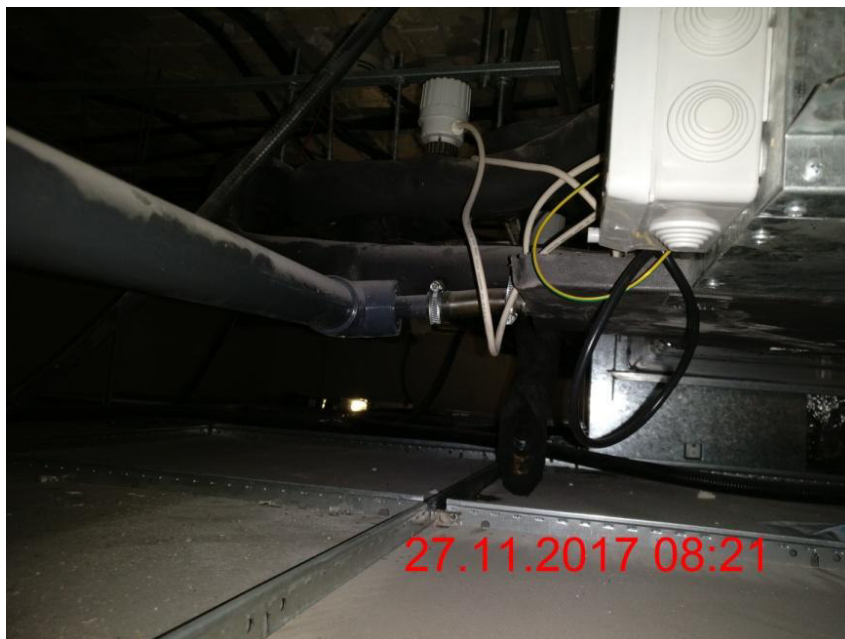
Ilustración 95: Tubería de Fan-coil de Consulta 9 Urgencias pediatría sin aislante térmico
