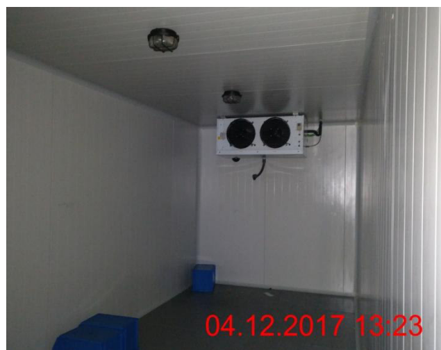
Ilustración 138: Cámara frigorífica 3 (Farmacia)
