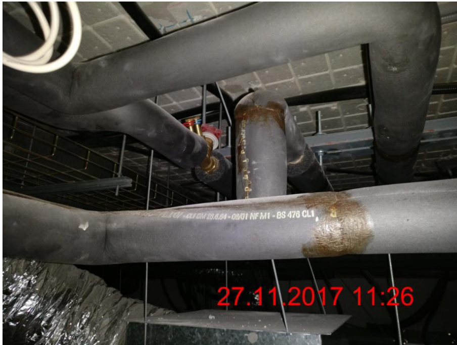
Ilustración 81: Válvula de Fan-coil de Sala de reuniones zona despachos sin aislante térmico
