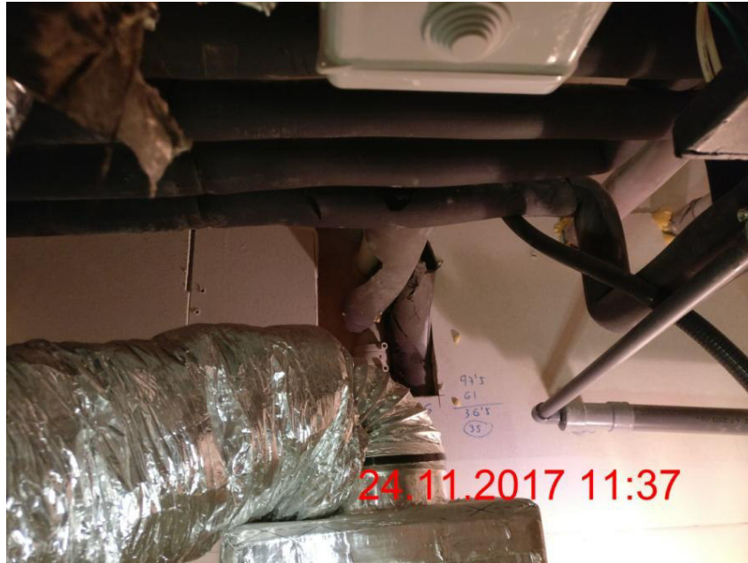
Ilustración 101: Fan-coil de Habitación 206 con aislamiento térmico dañado
