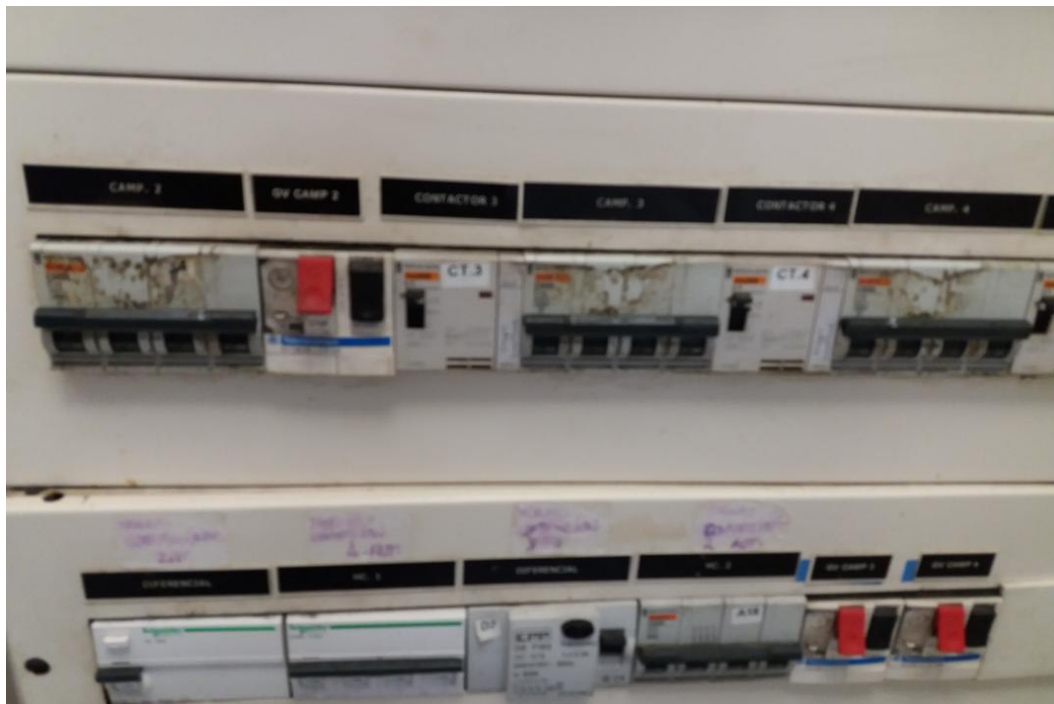
Ilustración 32: Cuadro eléctrico general de la cocina
