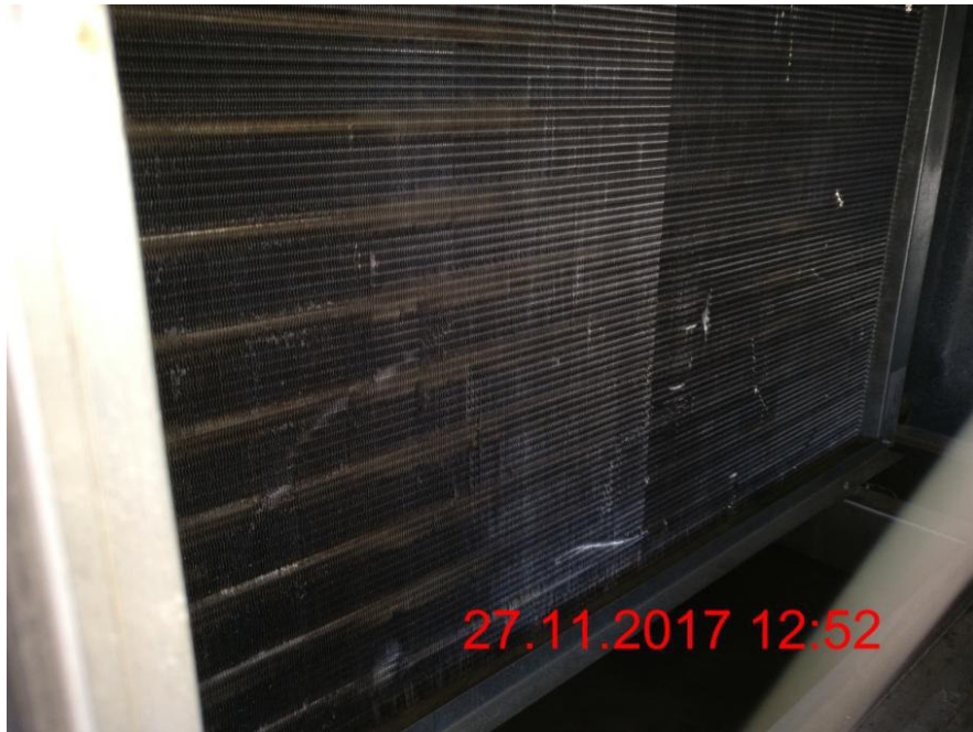
Ilustración 124: UTA 2 con baterías de frío y calor defectuosas
