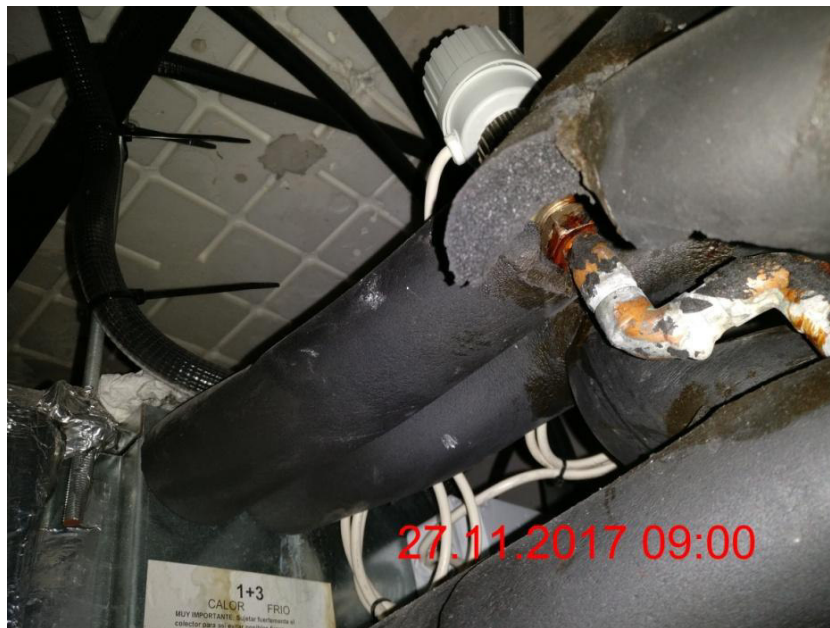
Ilustración 89: Tubería de Fan-coil de Pasillo Preingresos sin aislante térmico
