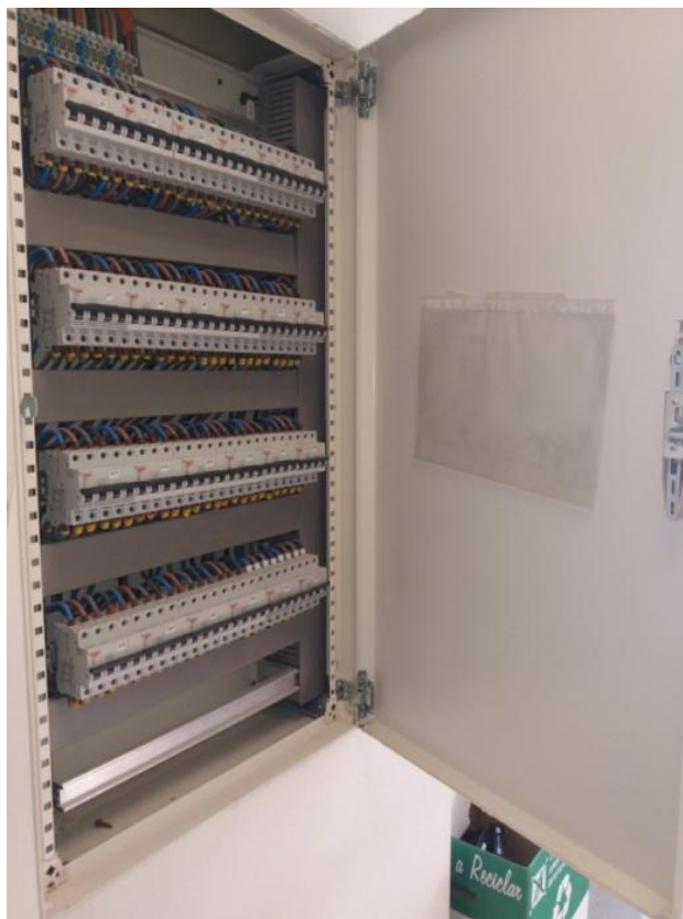
Ilustración 1: Cuadro eléctrico CDPA MONT 1
