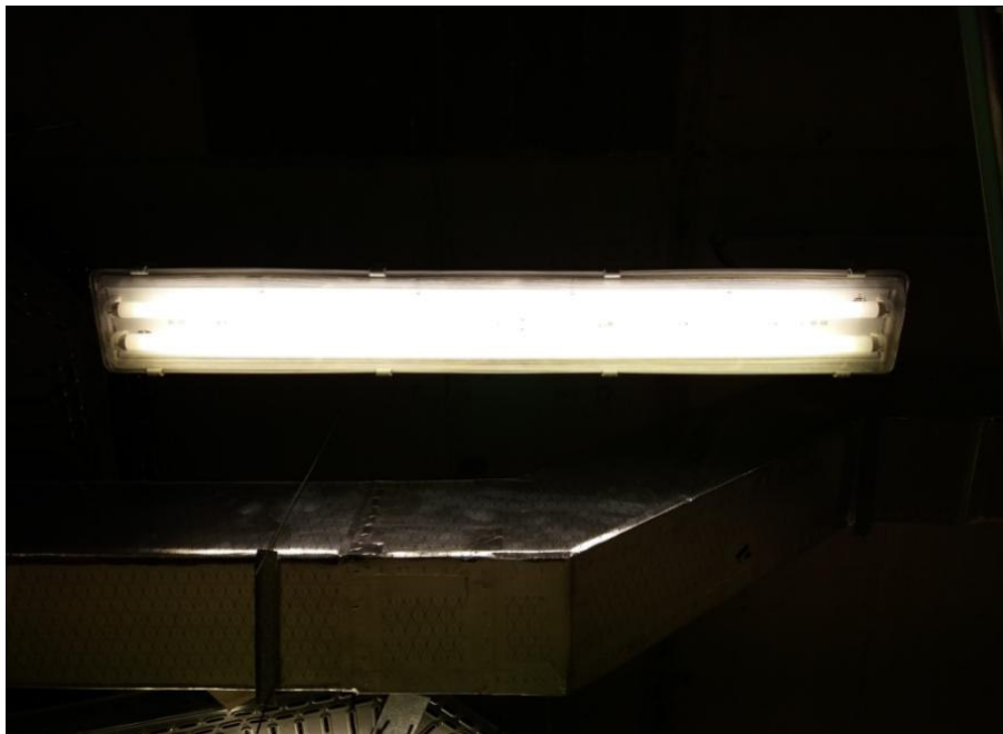
Ilustración 13: Luminaria fluorescente del cuadro eléctrico CGBT 1
