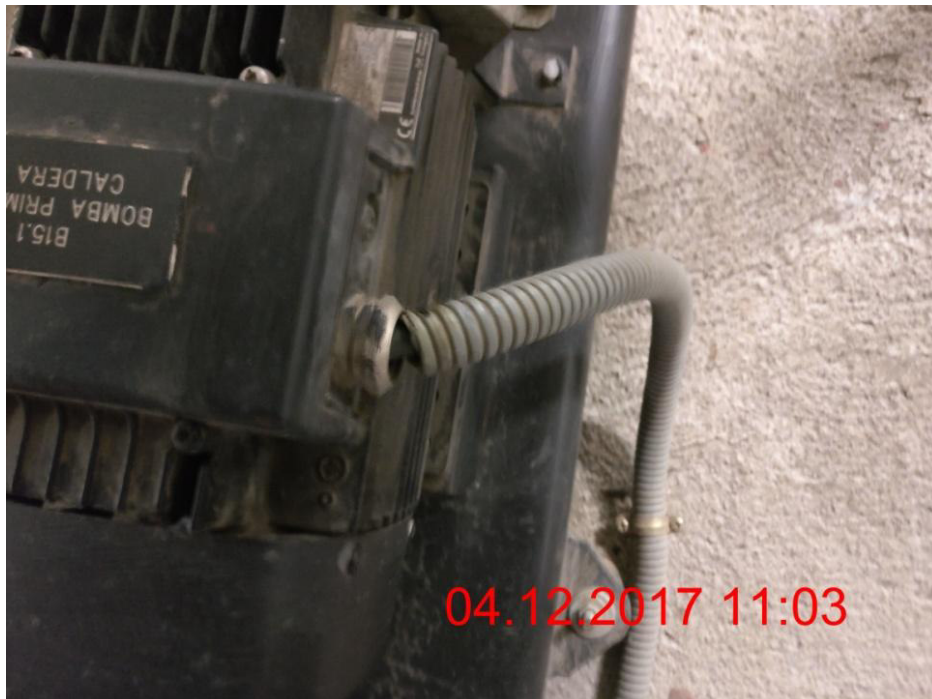
Ilustración 38: Recubrimiento del cableado mal conectado
