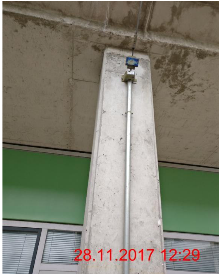
Ilustración 144: Pararrayos de zona F con contador de descargas defectuoso
