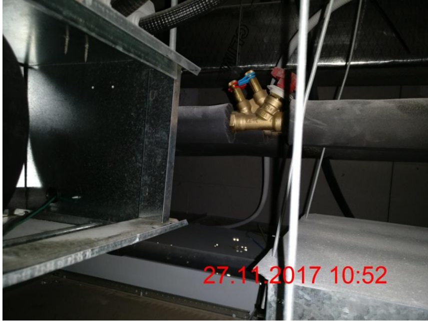
Ilustración 85: Válvula de Fan-coil Sala reuniones sin aislante térmico
