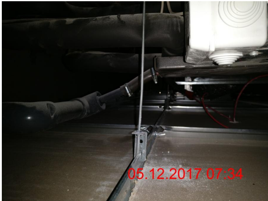
Ilustración 117: Fan-coil zona endocrinología con falta de aislamiento
