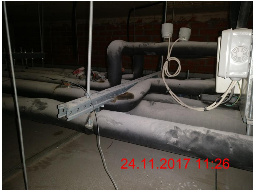
Ilustración 71: Válvula de Fan-coil F 208 sin aislante térmico
