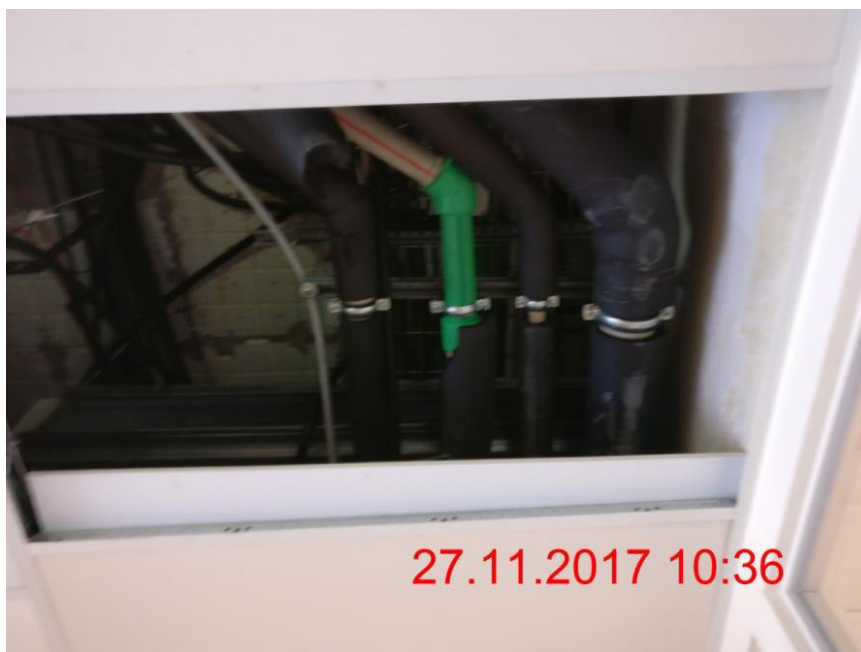
Ilustración 91: Tubería de Fan-coil de Pasillo despacho admisión sin aislante térmico
