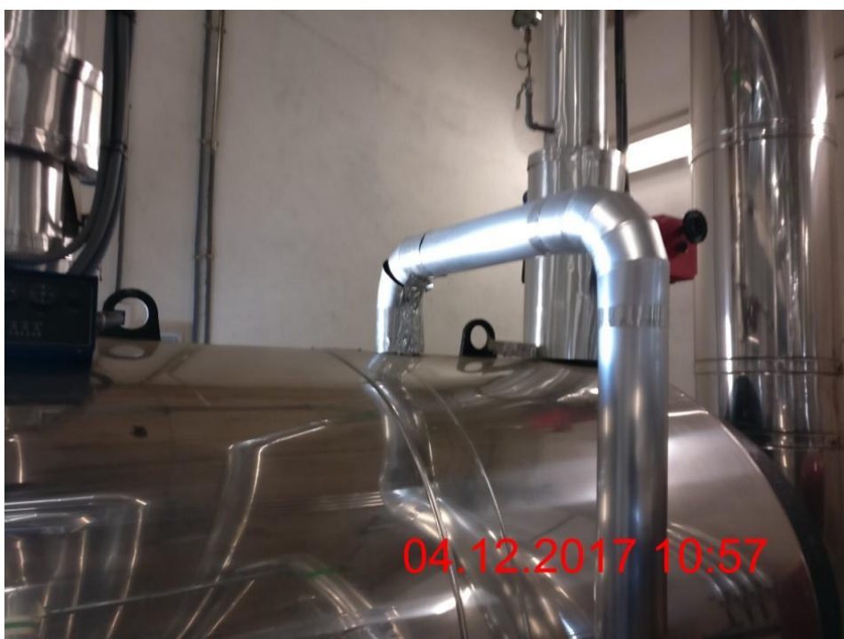
Ilustración 40: Recubrimiento inadecuado de tuberías y uniones
