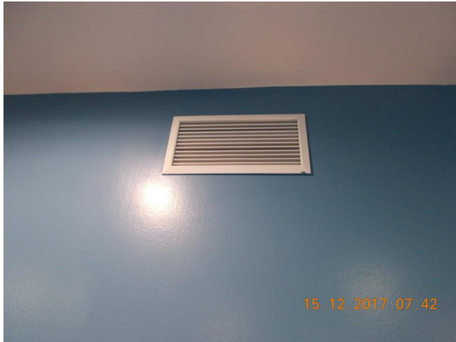
Ilustración 146: Rejilla metálica de Quirófano 13 sin puesta a tierra
