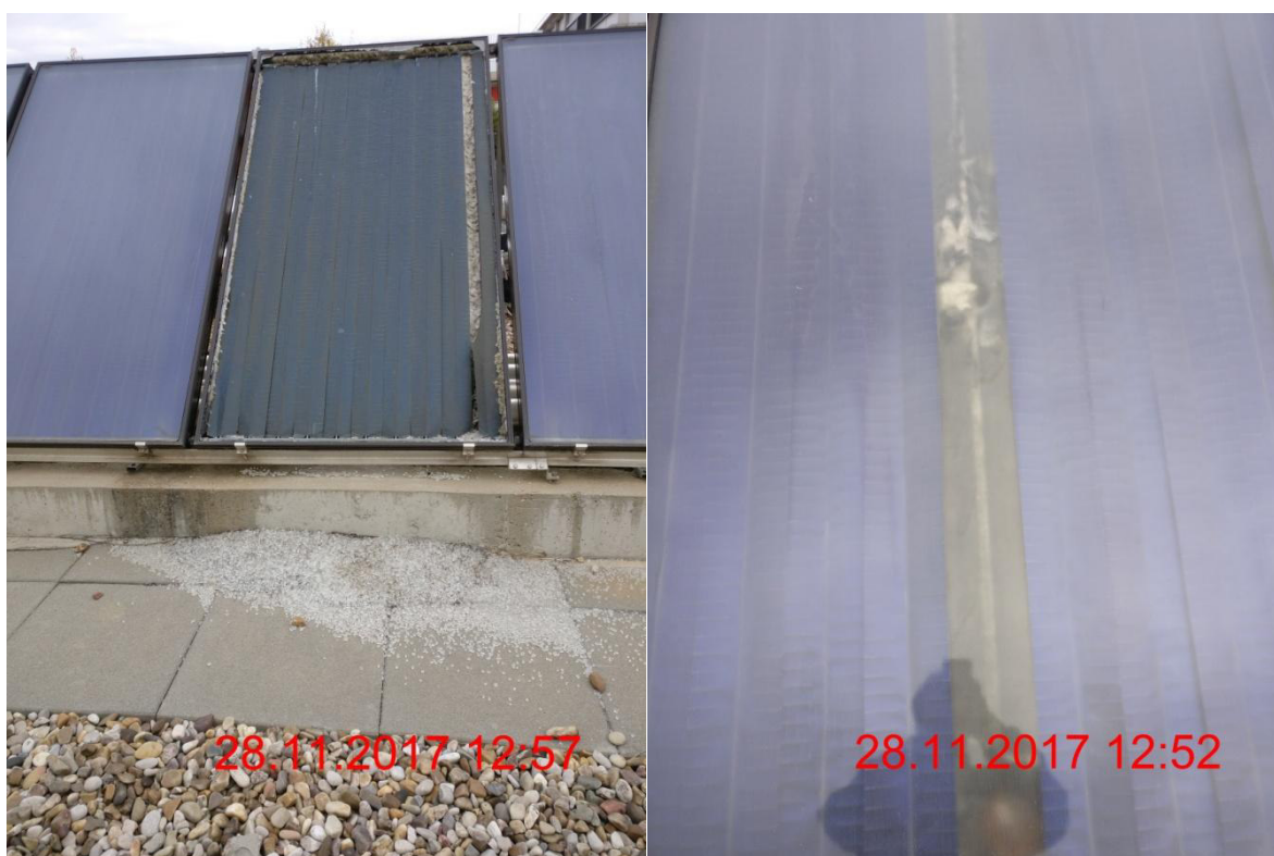
Ilustración 157: Colectores solares rotos y deteriorados
