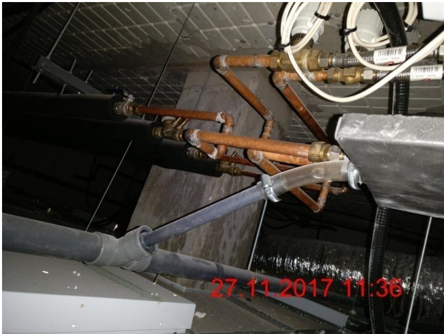
Ilustración 104: Fan-coil de Zona de servicio (geriatría) con tuberías sin calorifugar
