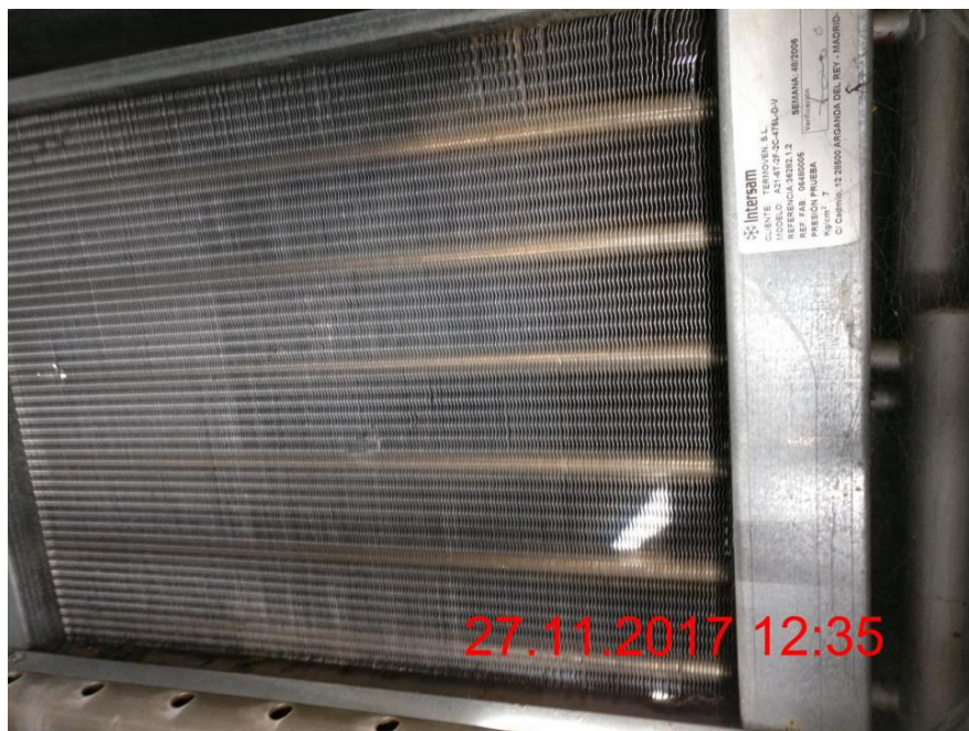
Ilustración 123: UTA 26 con baterías de frío y calor sucias
