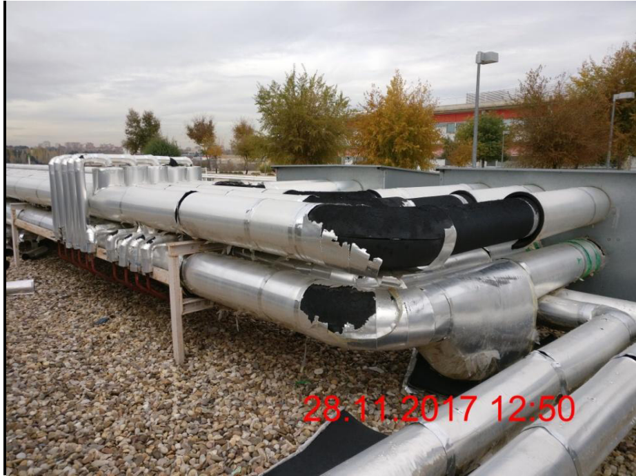
Ilustración 154: Instalación solar térmica con numerosos fallos de aislamiento
