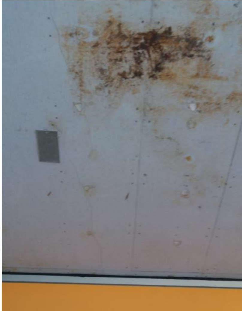
Ilustración 149: Humedad presente en la fachada exterior de la entrada principal del hospital
