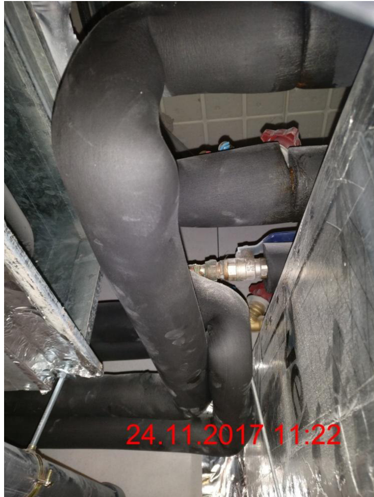
Ilustración 107: Fan-coil de Habitación 226F con válvulas sin aislar
