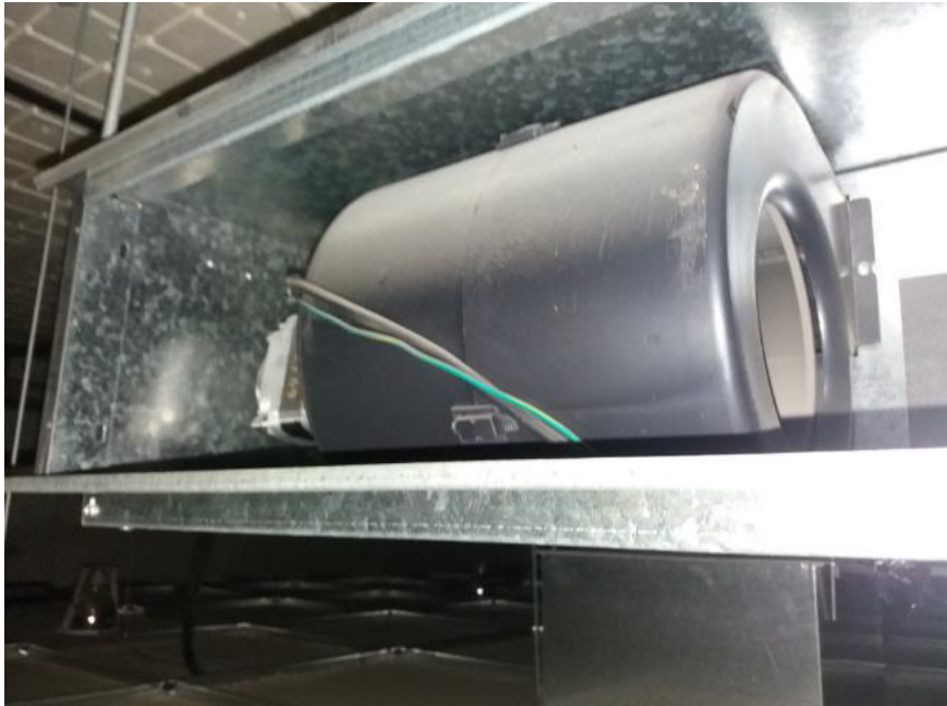
Ilustración 97: Fan-coil de la consulta 74 sala de esfuerzo con suciedad interior
