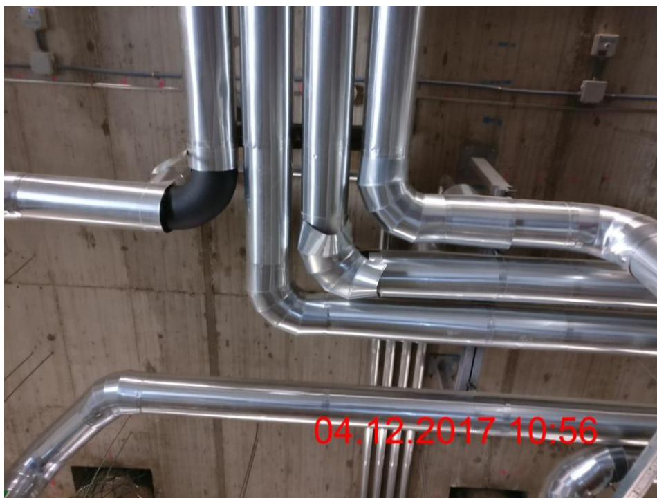
Ilustración 39: Recubrimiento inadecuado de tuberías y uniones
