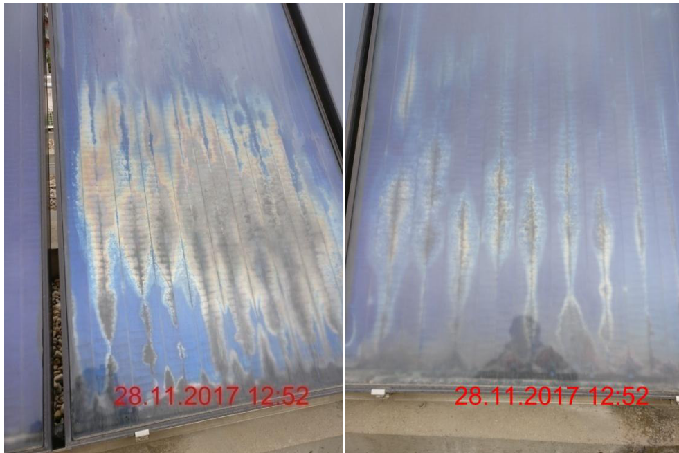
Ilustración 155: Colectores solares rotos y deteriorados
