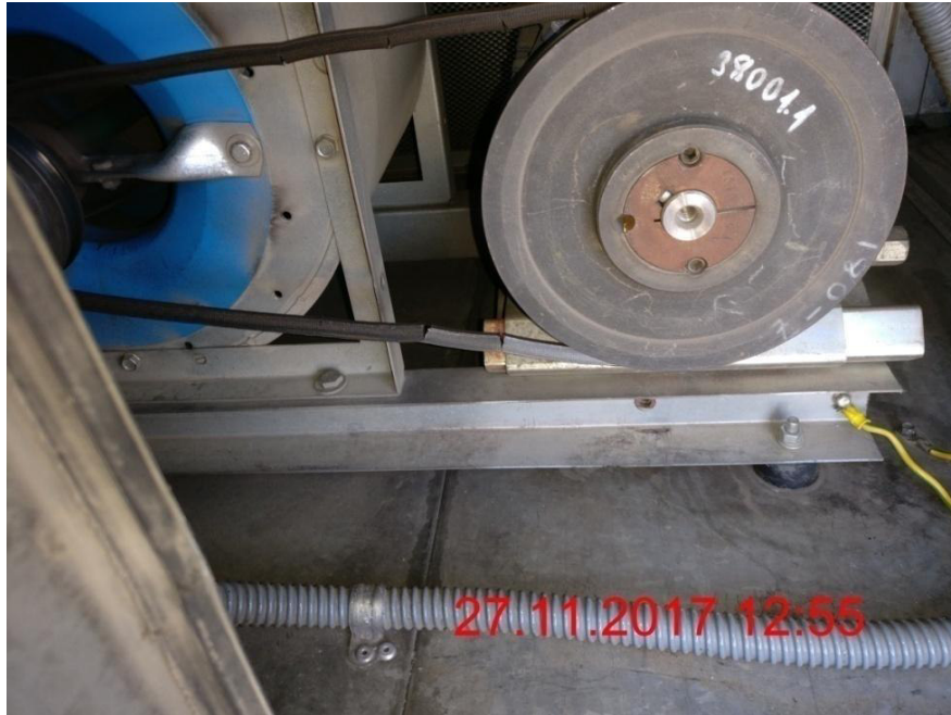
Ilustración 122: UTA de zona Neonatos con correa de transmisión defectuosa
