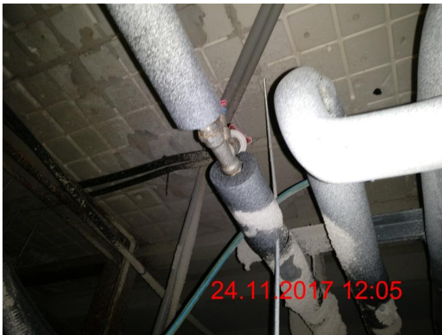
Ilustración 73: Válvula de Fan-coil de Reanimación urgencias sin aislante térmico
