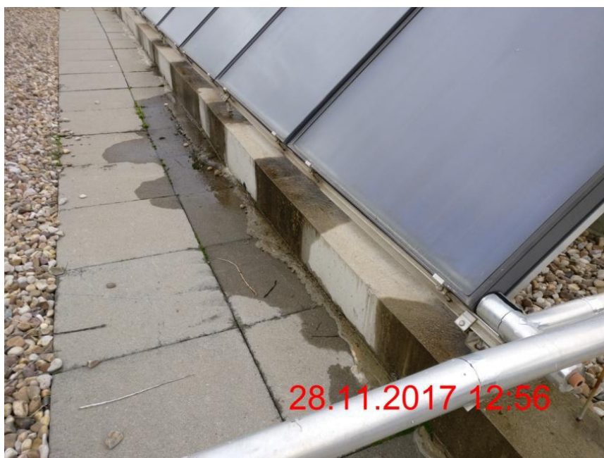
Ilustración 156: Colectores solares rotos y deteriorados
