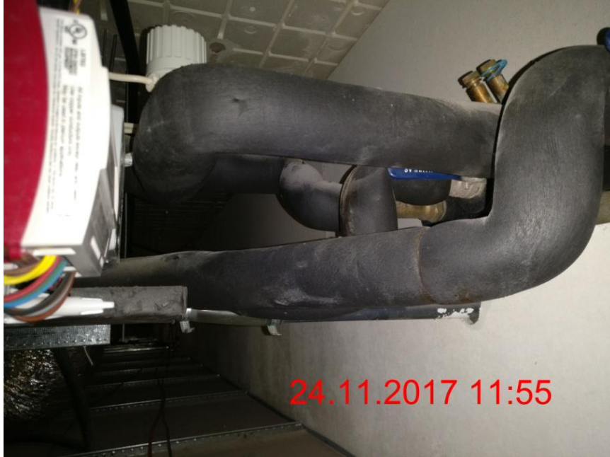
Ilustración 87: Válvula de Fan-coil de Pasillo información a familiares sin aislante térmico
