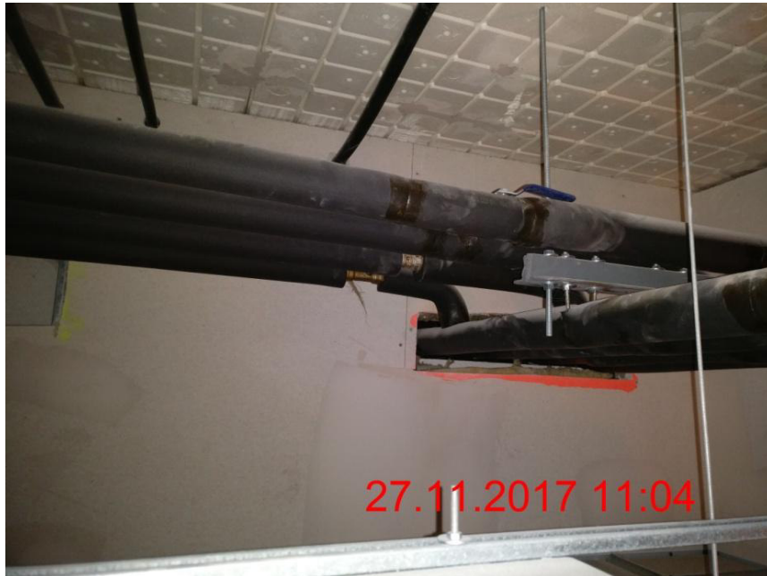
Ilustración 83: Válvula de Fan-coil de Dormitorio superior guardia sin aislante térmico
