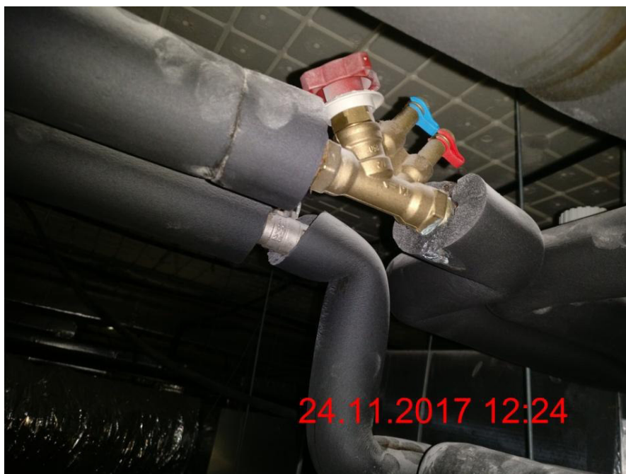
Ilustración 75: Válvula de Fan-coil de Sala de espera 4 radiologías sin aislante térmico
