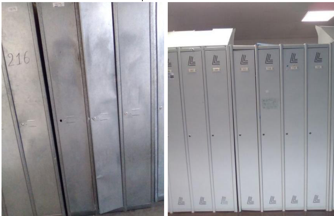
Armarios ropero modular deteriorados
