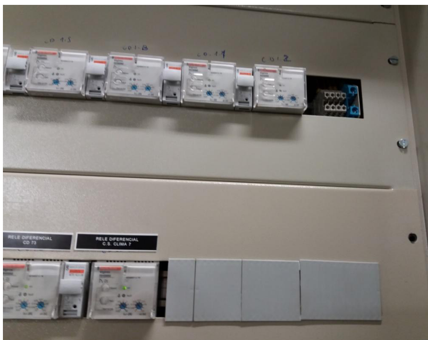
Ilustración 14: Cuadro de distribución en desuso del cuadro eléctrico CGBT 1
