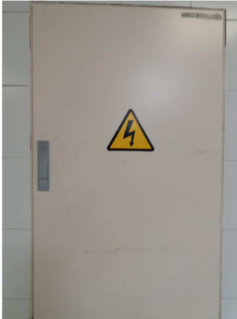
Ilustración 16: Cuadro eléctrico 7S CAF23
