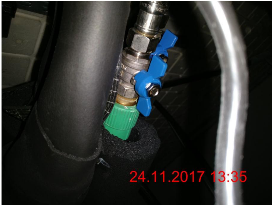
Ilustración 77: Válvula de Fan-coil de Planta A (Preparación medicamentos) sin aislante térmico
