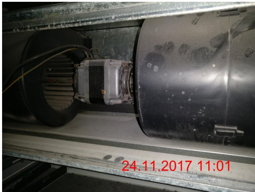
Ilustración 119: Fan-coil de despacho digestivo 1 (sala de espera) con suciedad interior
