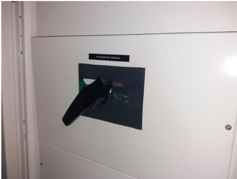
Ilustración 8: Cuadro eléctrico 65 CAF1.
