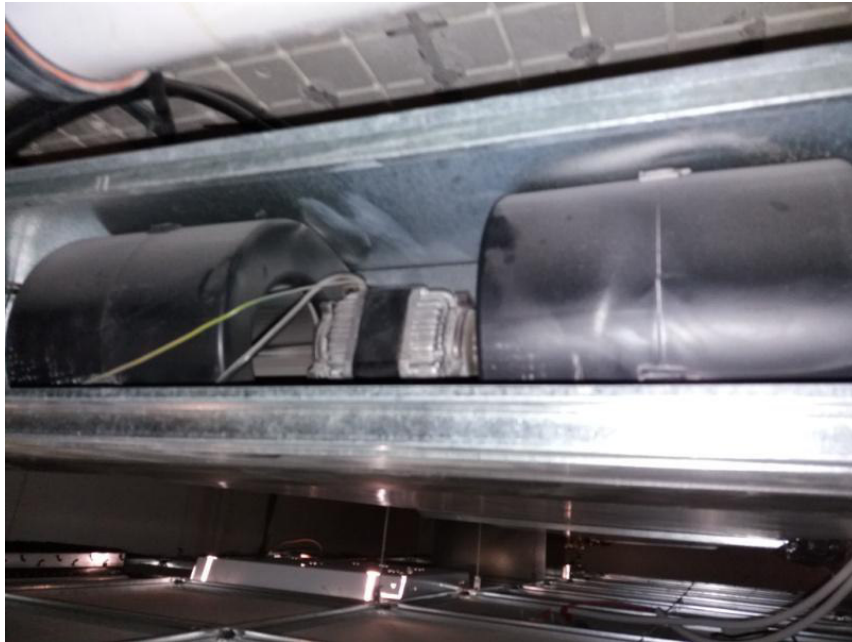
Ilustración 99: Fan-coil del vestuario V1001M con suciedad interior
