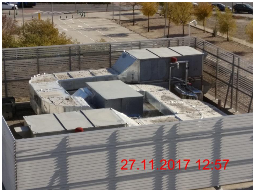
Ilustración 125: Varias UTAs con estado exterior deteriorado
