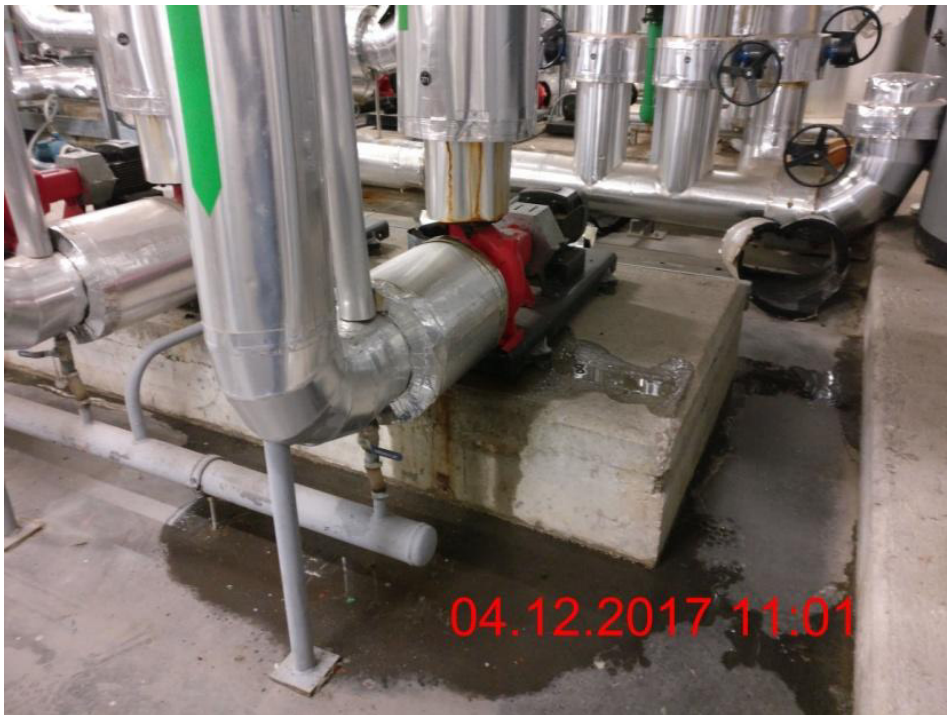
Ilustración 37: Una de las bombas de las calderas con fuga de agua
