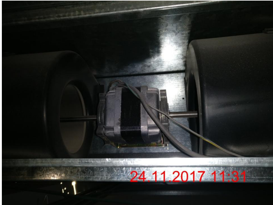
Ilustración 115: Fan-coil de la zona de ascensores F con motor averiado
