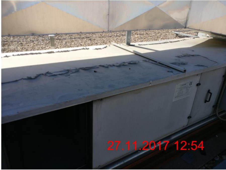
Ilustración 126: Varias UTAs con estado exterior deteriorado
