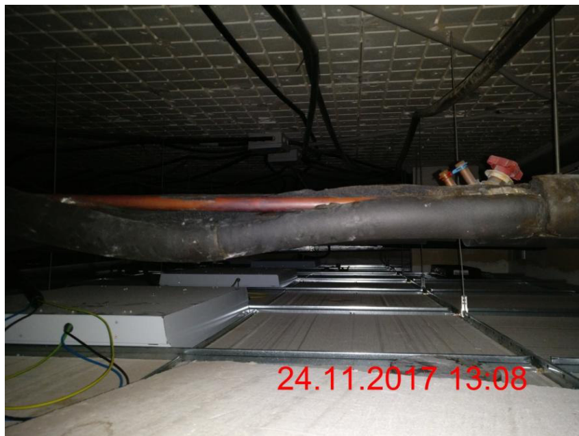
Ilustración 93: Tubería de Fan-coil de Salón de juego 3F sin aislante térmico
