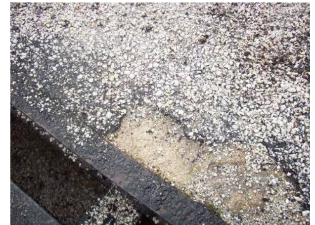
Detalle de desconchamiento superficial
