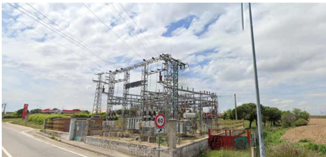
Fotografía 18. Subestación eléctrica "STR HUMANES" de conexión evacuación eléctrica. Fuente: AmbiNor.
