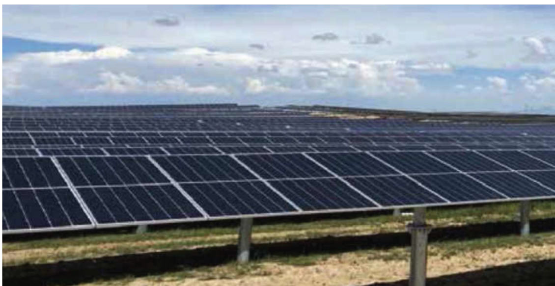
Figura 13. Seguidor solar. Fuente: Proyecto ejecución.
