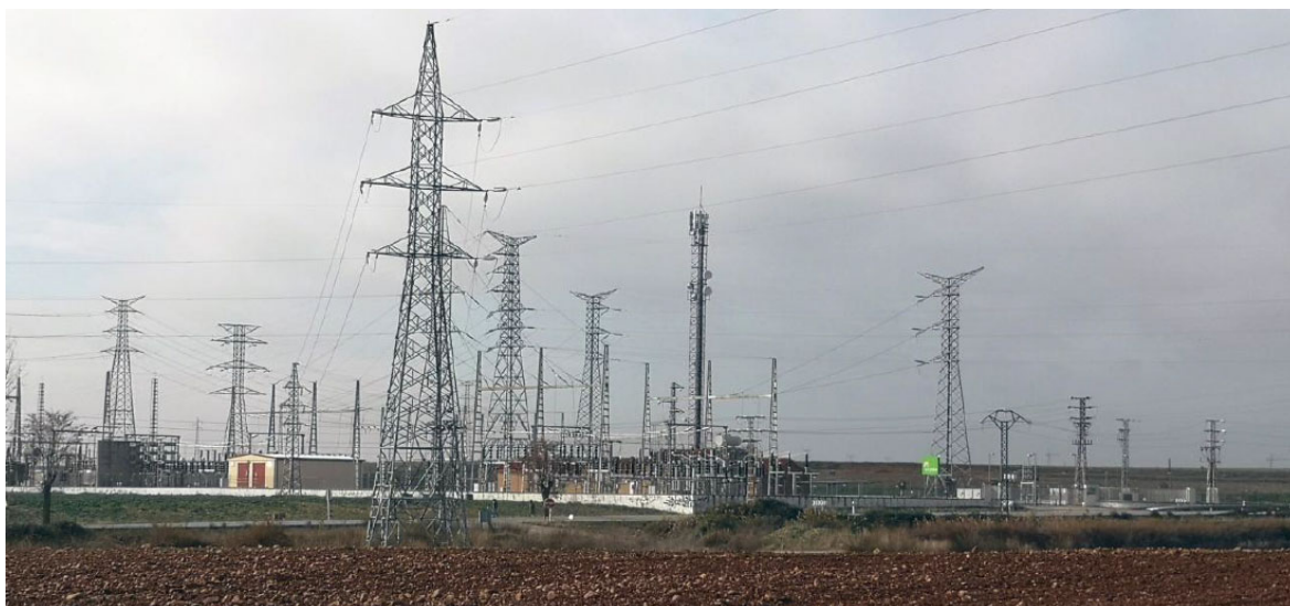
Vista de la subestación existente junto a la M-116 a la que se conectará mediante una línea subterránea de 132 kV la planta solar fotovoltaica
