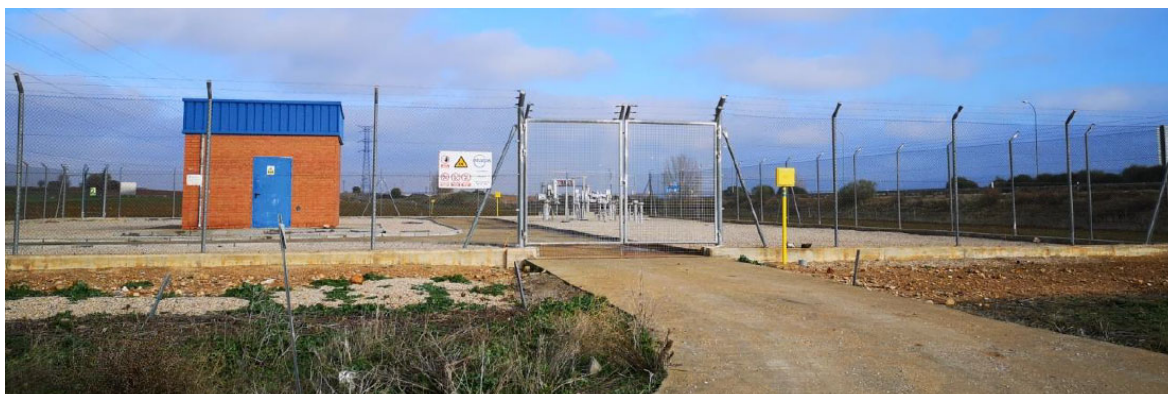
Centro de transporte del gasoducto Algete-Yela en la parcela 20501 del polígono 024
