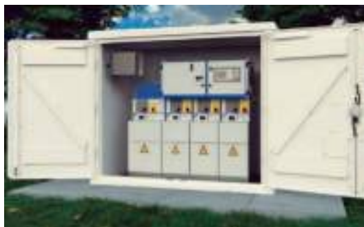
Imagen 11. Centro de seccionamiento tipo
