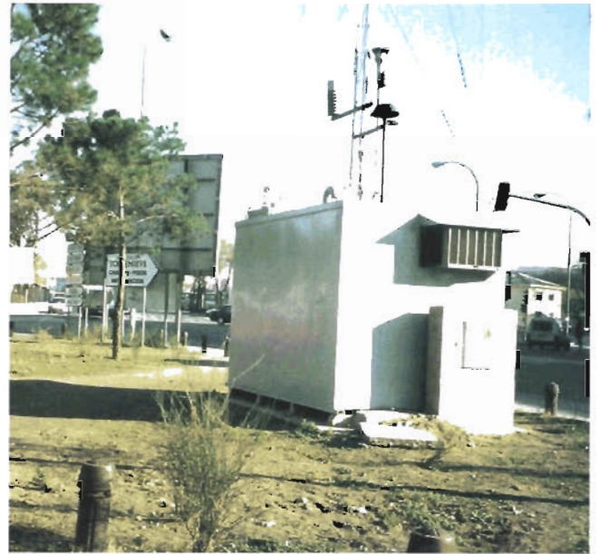
Instalación tipo de la red de control automática de la contaminación atmosférica gestionada por la Consejería de Medio Ambiente y Desarrollo Regional (Torrejón de Ardoz)
