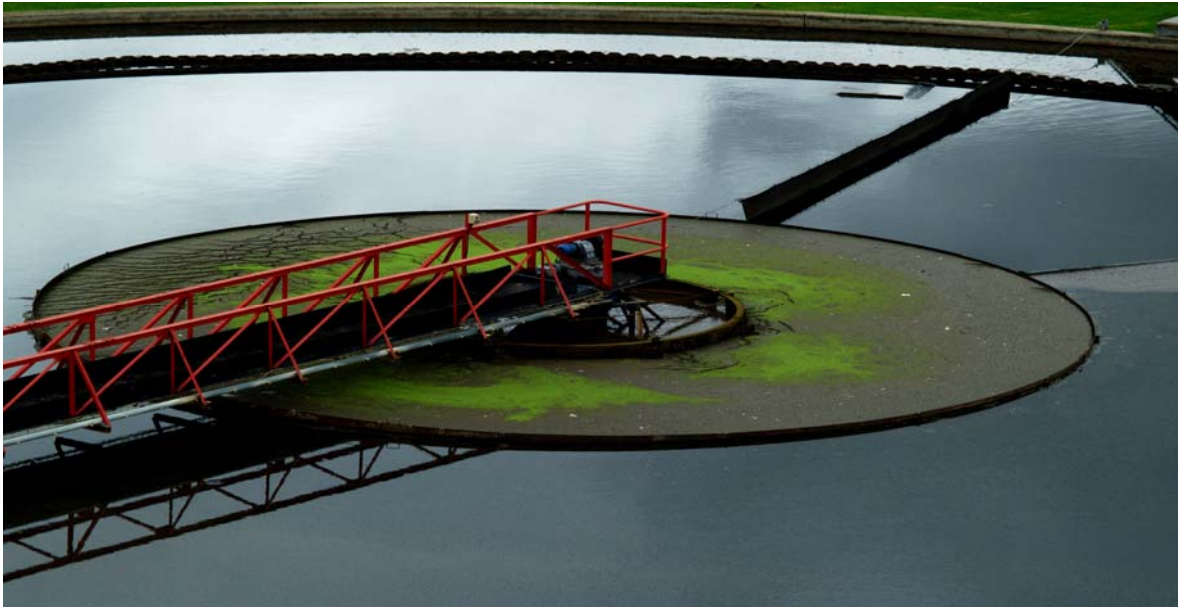
Decantador secundario del proceso de depuración de aguas residuales.
