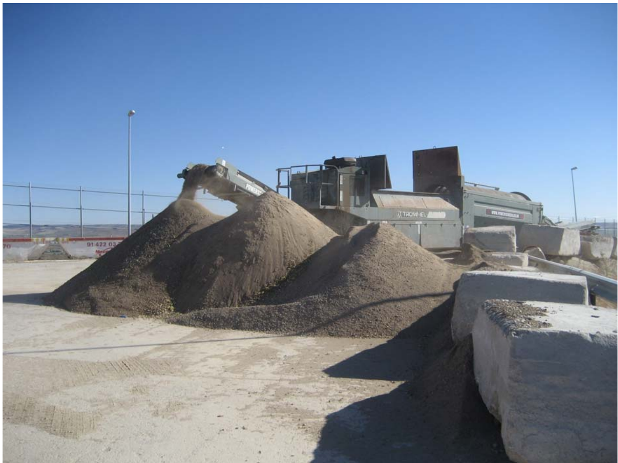
Instalación de valorización de residuos de la construcción y demolición
