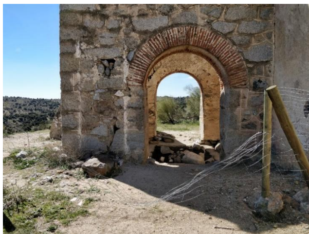
Detalle cerramiento vallado caído
