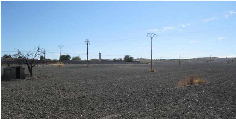
Línea eléctrica de media tensión en la noroeste del ámbito
