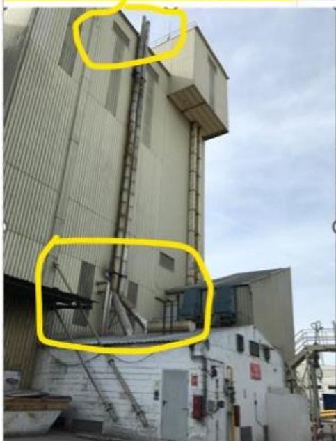
VISTA EXTERIOR - FOCOS 7,8 - CALDERAS
