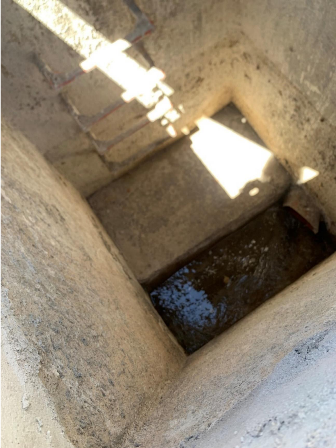
Fotografía 2. Arqueta de toma muestras acometida de aguas sanitarias (P2).
