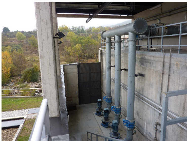
Figura 3.2.3.7.2.1.- Vista bombas sin cerramiento perimetral. (Fuente: Canal de Isabel II)
