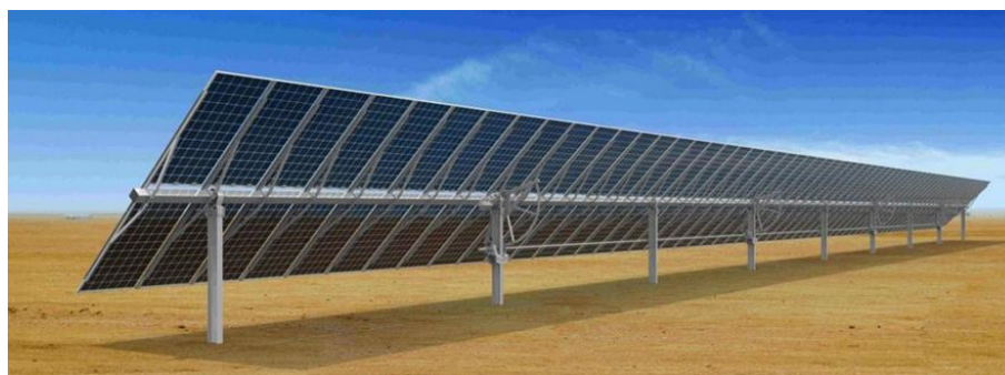
Fig. Seguidor solar. Fuente: proyecto ingeniería anexo al presente PEI
