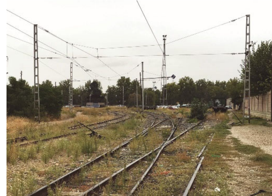
Playa de vías y catenarios de los ferrocarriles.
