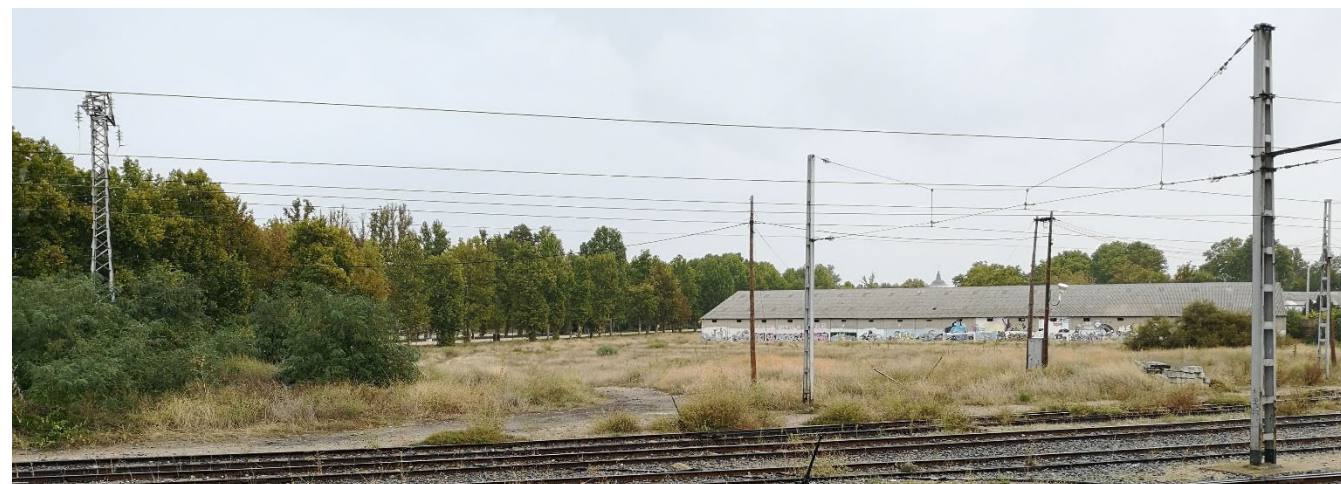
Red Eléctrica y Catenaria
