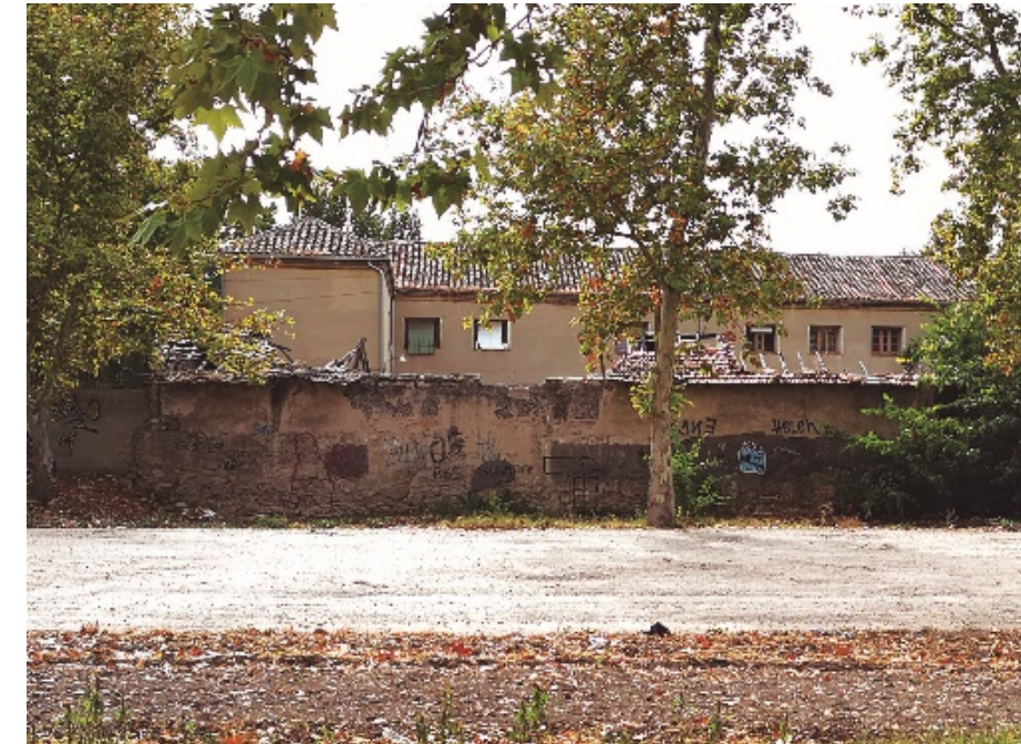
Ejemplo de edificación en estado de abandono.
