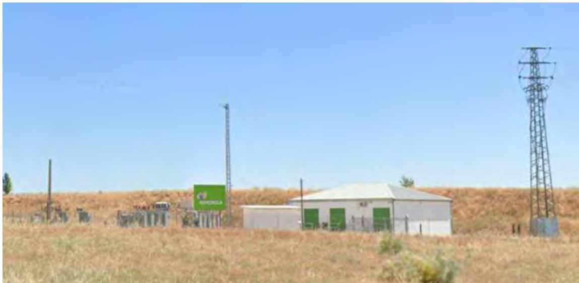
Figura 4.5.e Imagen subestación Navalcarnero en su aspecto de agosto de 2012 y aspecto actual
