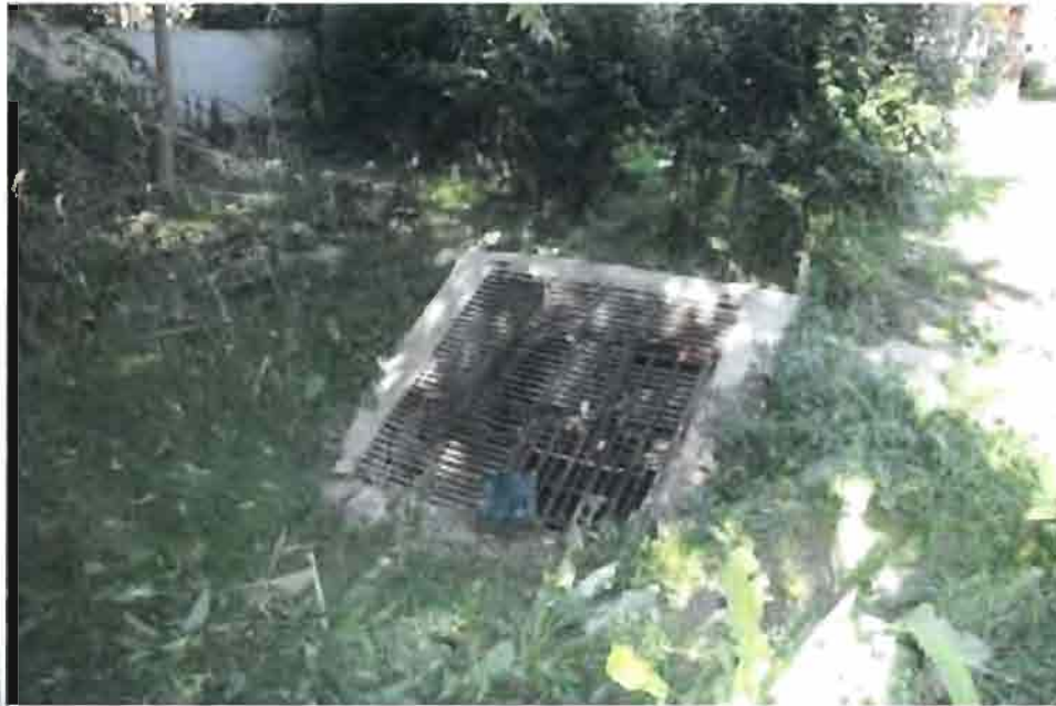
Colector de aguas, de tamaño superior a 1 m 2 , en las inmediaciones de la calle C/d Campeador con fuertes emisiones de olores, que puede suponer un riesgo para la salud pública
