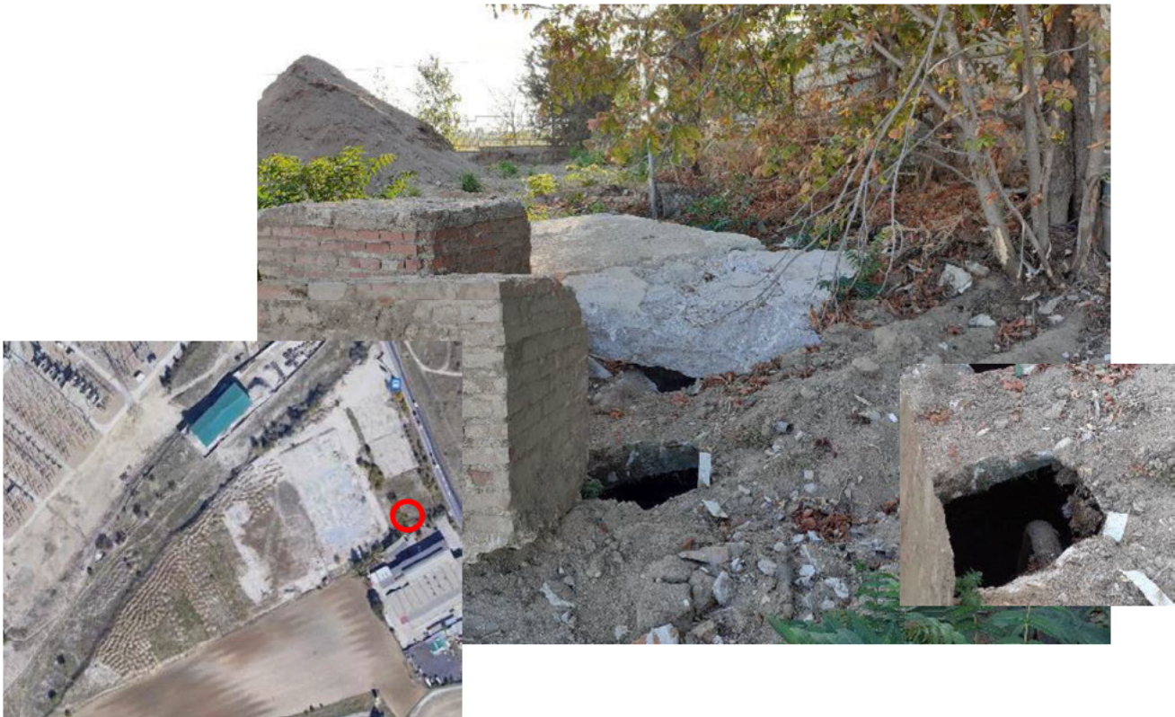
Ilustración 11. Estado de los dos pozos ubicados al Sureste de la parcela y ubicación
