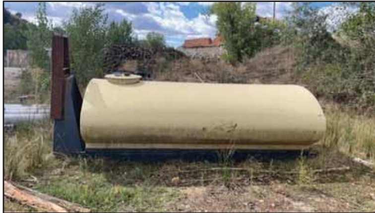
Figura 22: Cisterna de 5.000 litros. Fuente: Elaboración propia.
