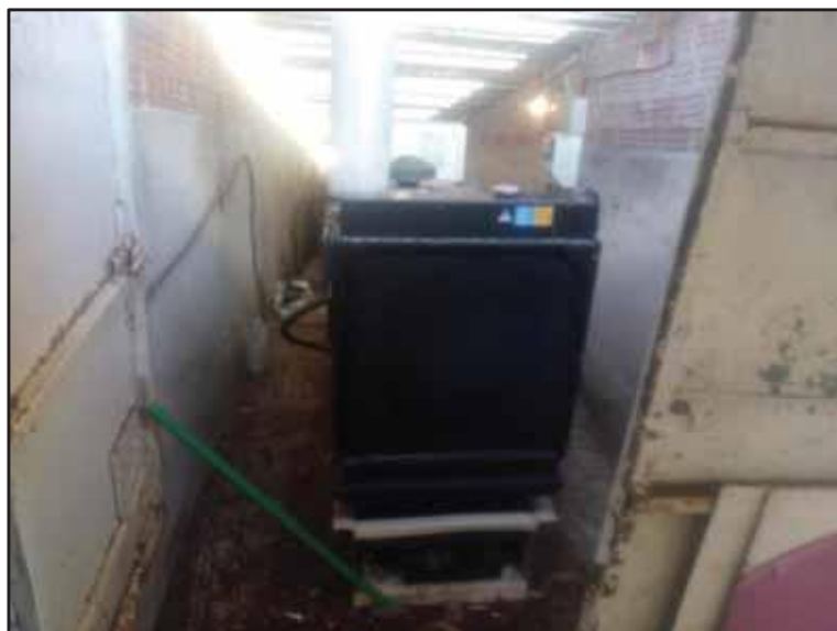
Figura 12: Grupo electrógeno. Fuente: Elaboración propia.
