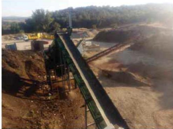
Sistema de cribado de tierra vegetal.
