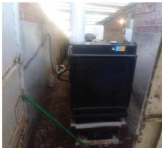
Grupo electrógeno de gasóleo.
