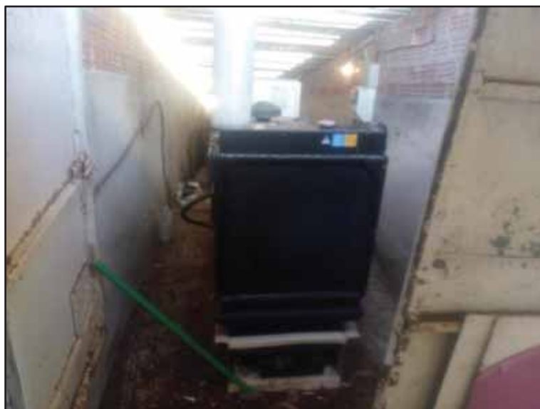
Figura 12: Grupo electrógeno. Fuente: Elaboración propia.
