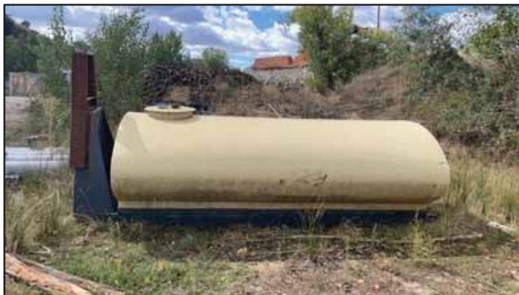
Figura 22: Cisterna de 5.000 litros. Fuente: Elaboración propia.
