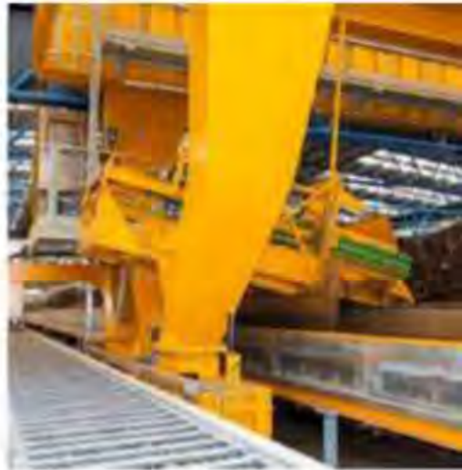
Figura 32. Sistema de descarga mediante fresa.
