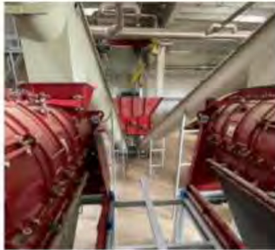
Figura 10. Trito-centrifugas separación de materia orgánica.
