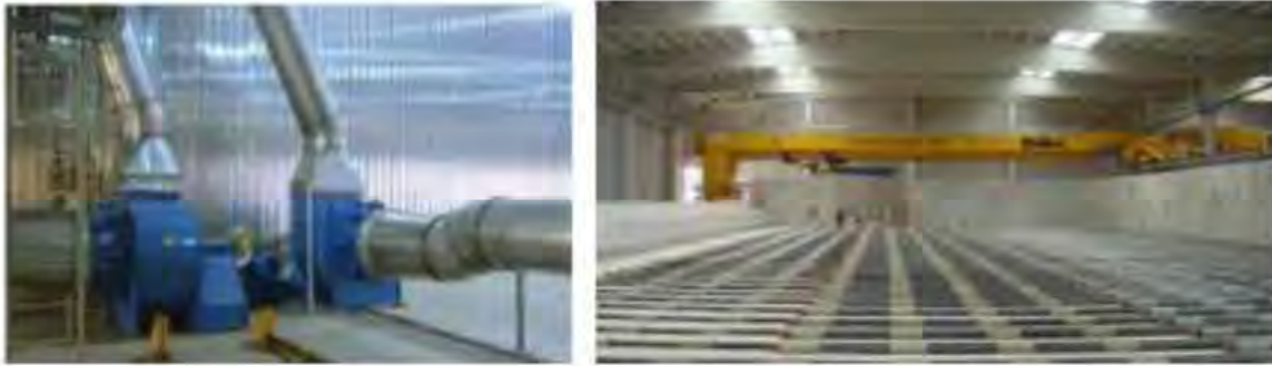
Figura 30. Ventiladores y fondo del sistema de aspiración forzada.
