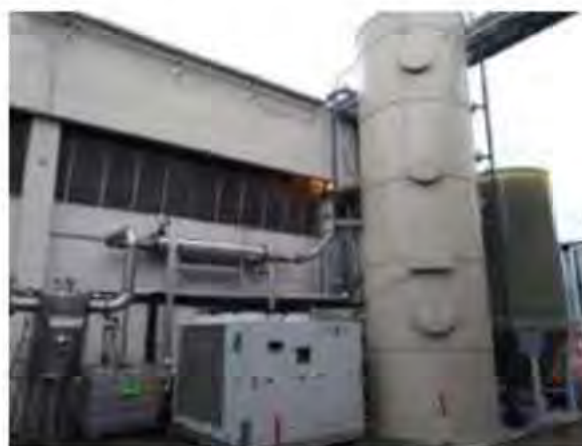
Figura 20. Torre de lavado y enfriador del biogás producido por el digestor anaerobio.
