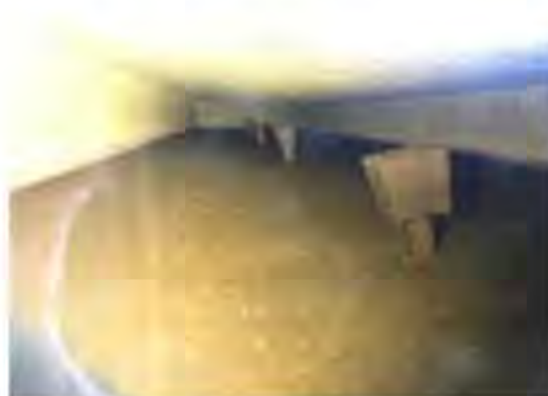
Figura 16. Interior del reactor anaerobio. Eje de mezcla horizontal en todo el largo.
