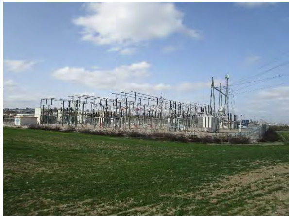
Foto 24. Pk. final en la subestación de Pinto.
