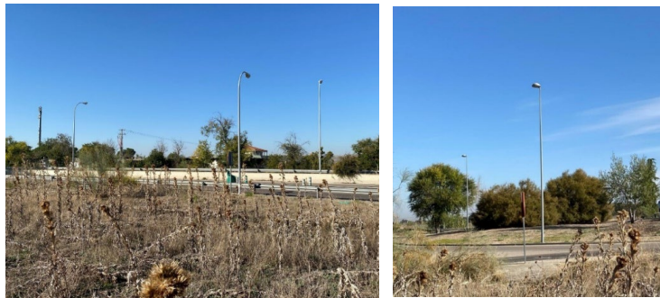
TRAMO DE ALUMBRADO EN LA M-305 Y BÁCULOS EN LA GLORETA EXISTENTE
