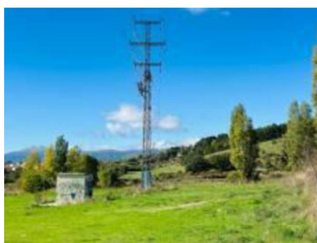
Fotografía 13. Vista de la línea eléctrica y CT hacia el oeste
