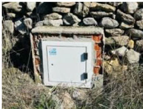
Fotografía 15. Vista del armario del Canal de Isabel II
