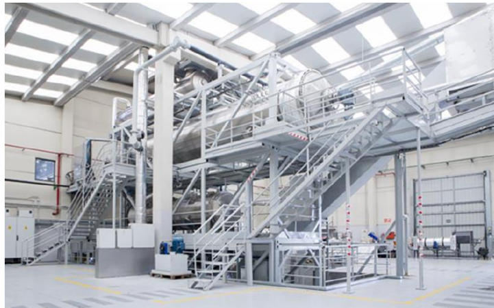
Ilustración 30. Planta de hidrólisis térmica [Fuente: ECONWARD]
