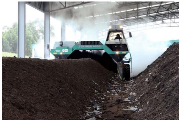
Ilustración 7. Sistema de pilas con máquina volteadora [Fuente: Imágenes archivo GRUPOTEC]
