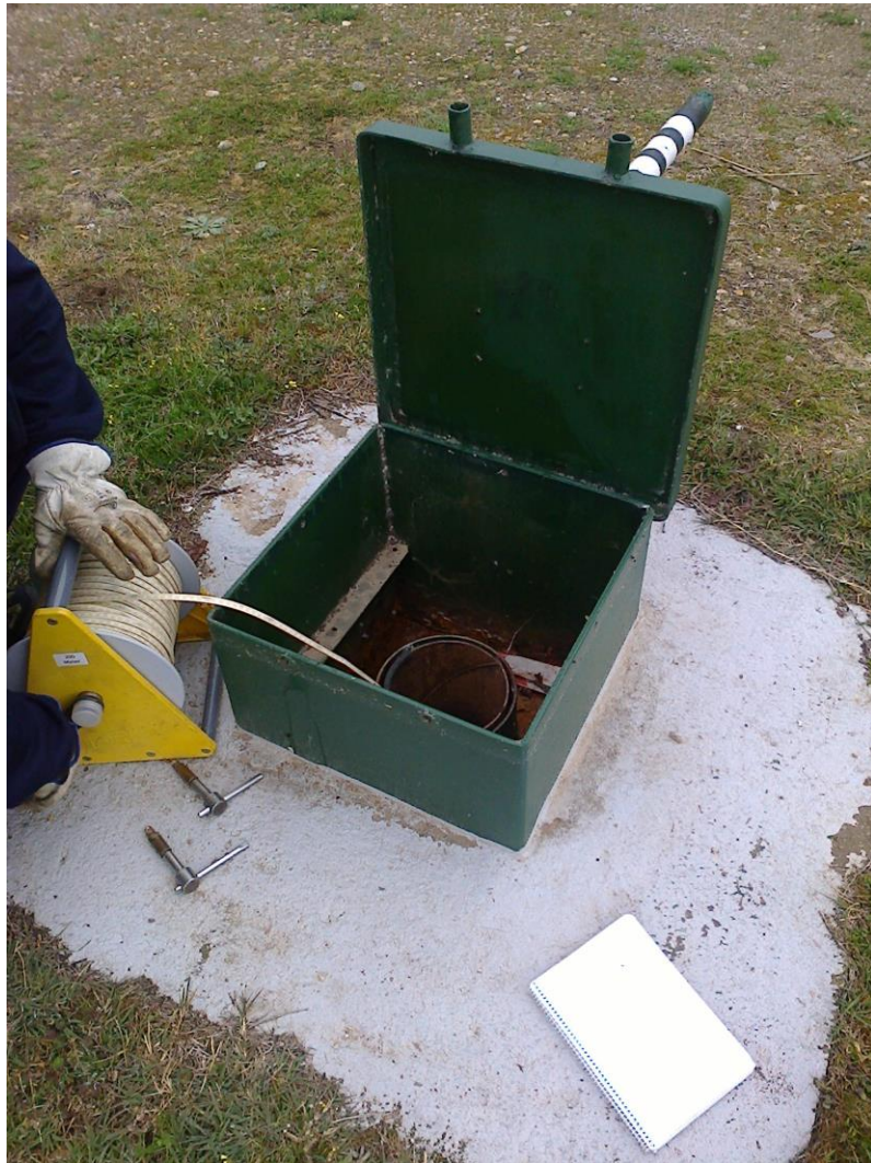
Foto 4. Medición de niveles con sonda manual en el piezómetro 03.04.004.
