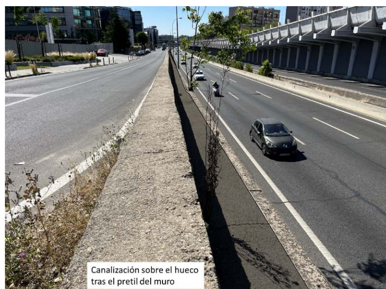
Figura 8: Canalización grapada a muro en Vía de los Poblados PK 4+300
