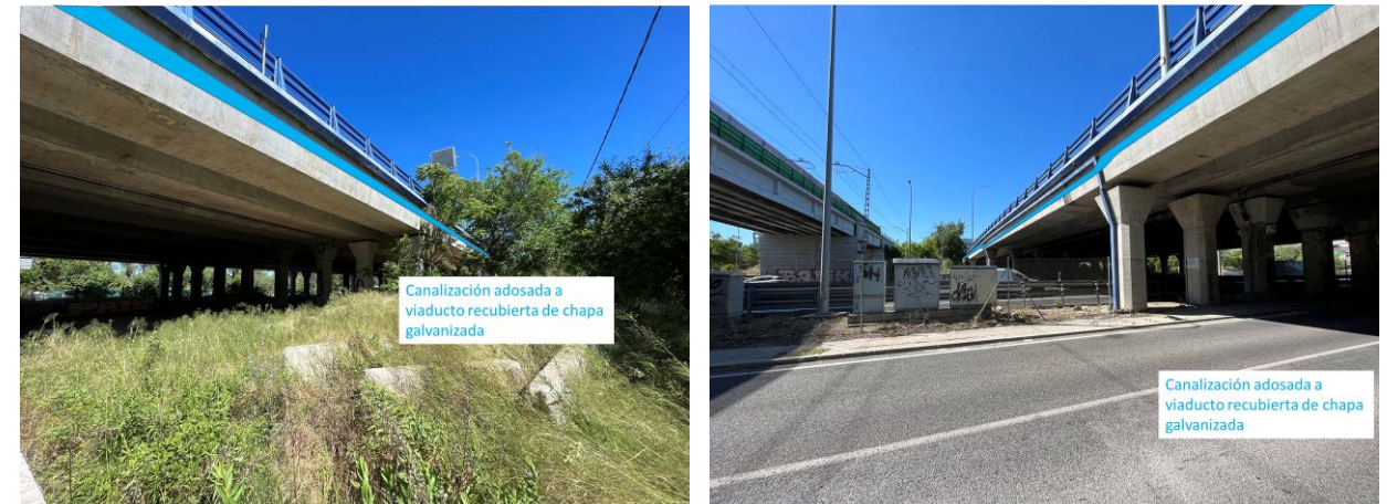
Figura 12: Cruce mediante canalización grapada a estructura sobre enlace A-2 en PK 8+600
