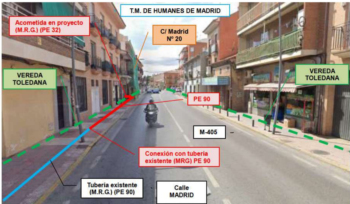
FOTO Nº 2: AFECCIÓN; VIA PECUARIA "VEREDA TOLEDANA". (Zona de conexión con tubería existente y paralelismo)
