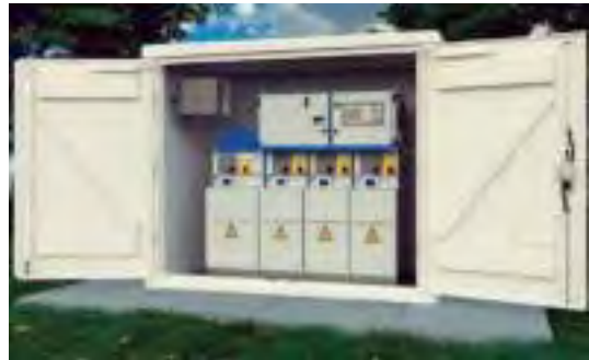
Imagen 11. Centro de seccionamiento tipo
